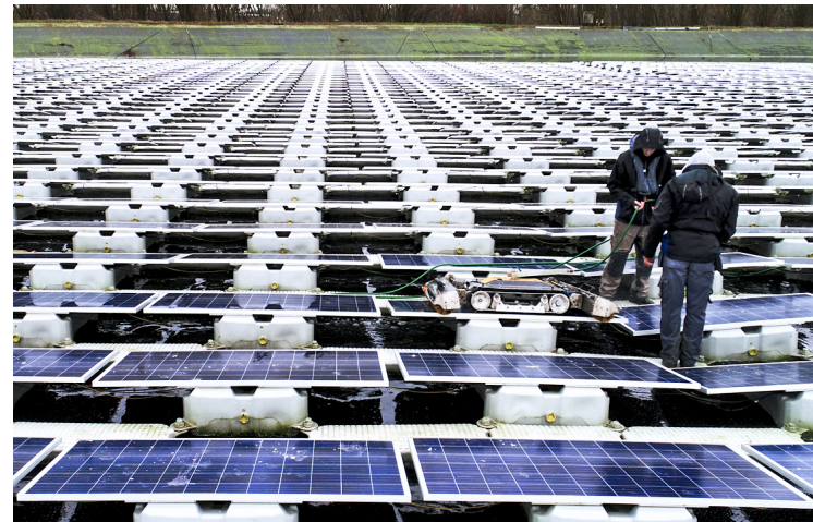
Una gamma di robot adatti a tutte le tasche e a tutti i tipi di installazioni di pannelli solari
